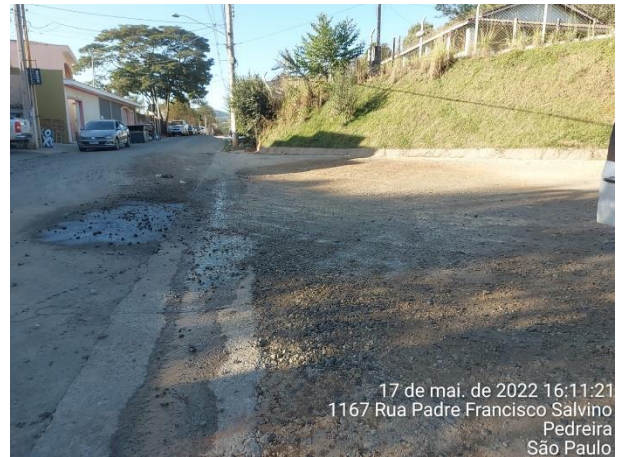
Foto 2 - Umectação, prevenção de suspensão de poeira da via MD03, entroncamento rua Padre Francisco Salvino. Data: (17/05/2022).
