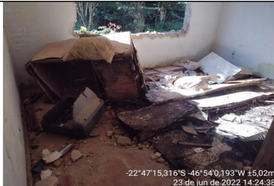
Foto 2 - Resíduos no interior da estrutura
